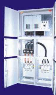
Rozdzielnicie pomiarowe półpośrednie
